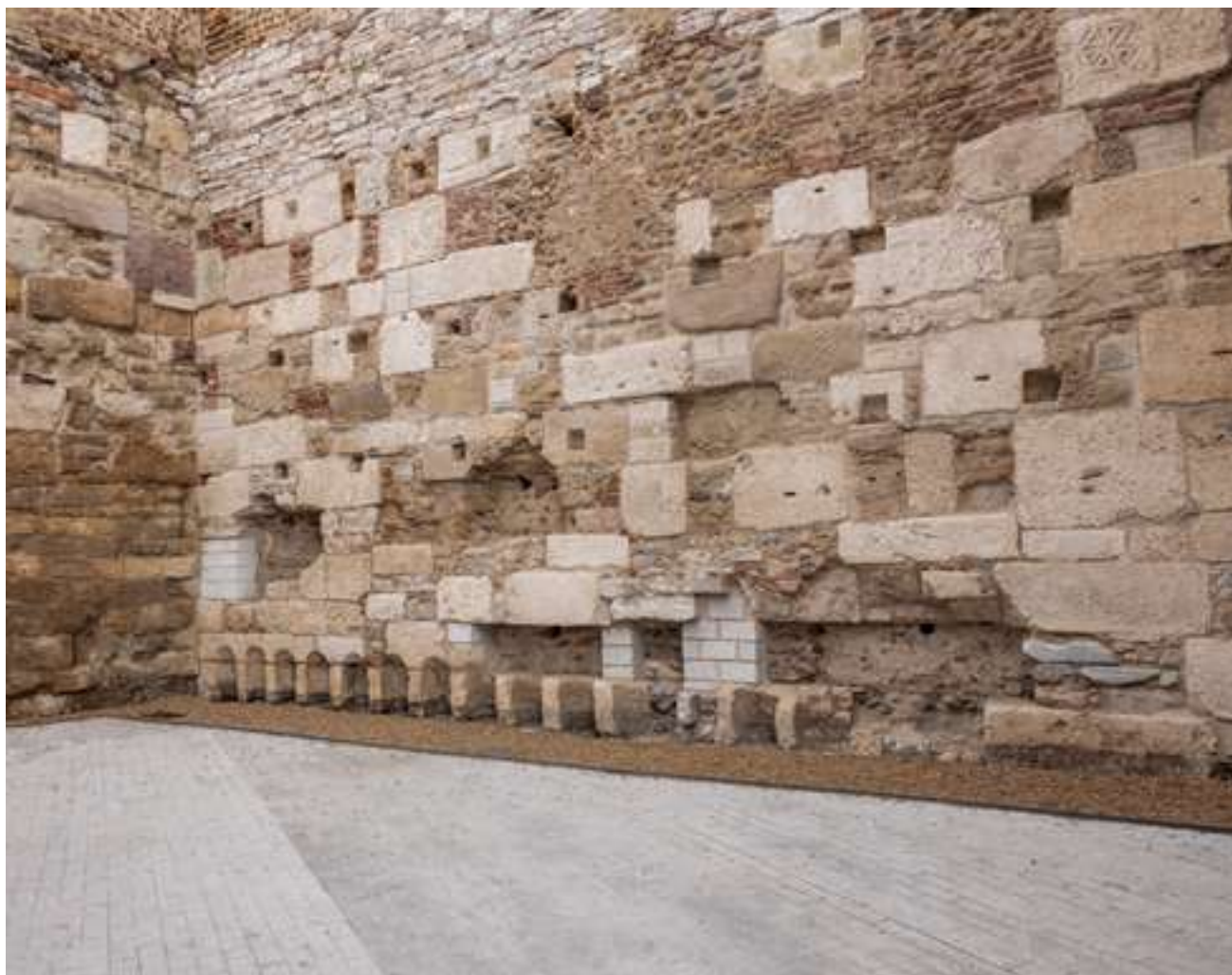
Fig. 5. Alternancia de fábricas en el paramento exterior de la muralla tardorromana. Era del Moro. Lienzo norte (Foto V. García Marcos).
